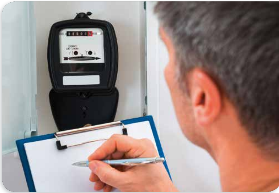
Der Gesetzgeber sieht für ältere Gebäude ab 2017 den sukzessiven Austausch der alten Zähler vor.
