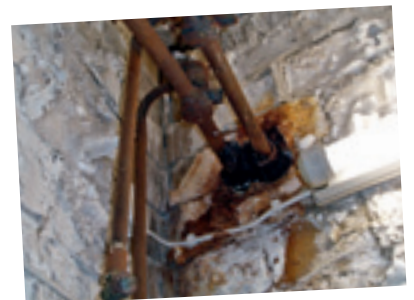
Die Korrosion ist im alten Wellenbad schon sehr weit fortgeschritten.
